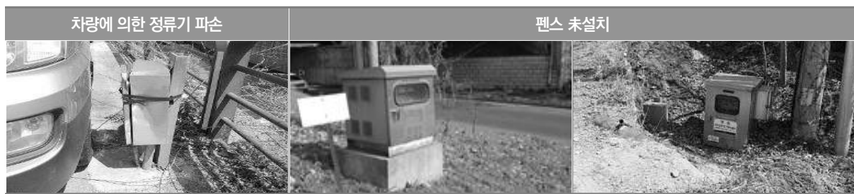
〈그림 7.2-9〉 전기방식설비 파손 사례
